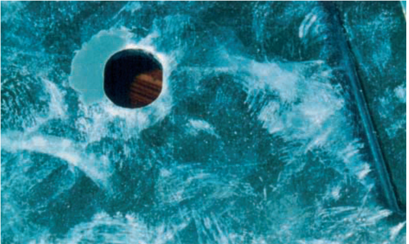
Eksempel på reparation af zinkafskalning omkring et udstanset hul i varmforzinket plade. Reparationen er udført med zinkstøvmaaling.
